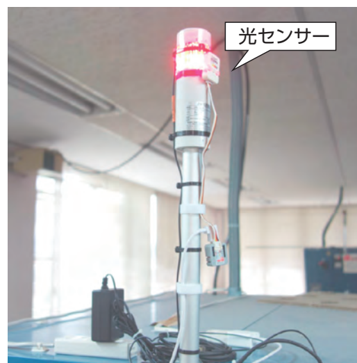
(B) センサー部 簡易遠隔監視装置の設置
