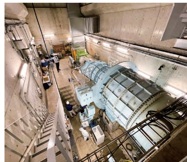
鬼石発電所 発電機室
